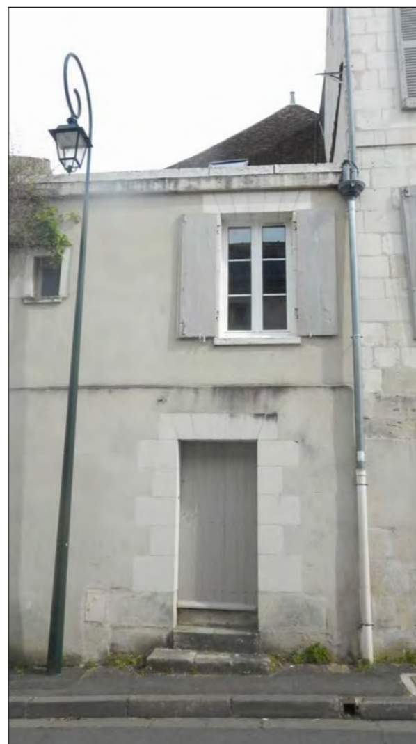
Fig.85 : Toit terrasse inadapté au bâti et au contexte paysagé
