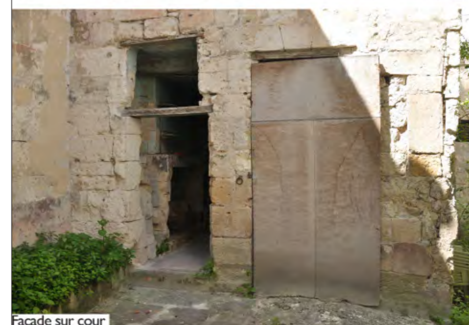
Fig.93 : Bâtiments dont l'état menace la sécurité
