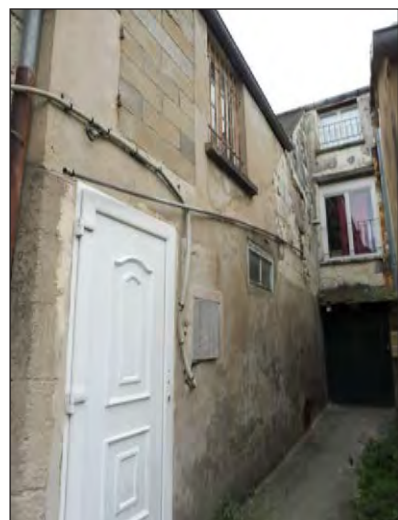
Fig.88 : Bâtiment aux modes constructifs incohérents et dégradant l'état sanitaire de l'ensemble.
