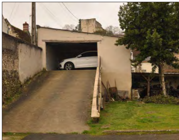
Fig.84 : Désordre structurel et plan de toiture inadapté
