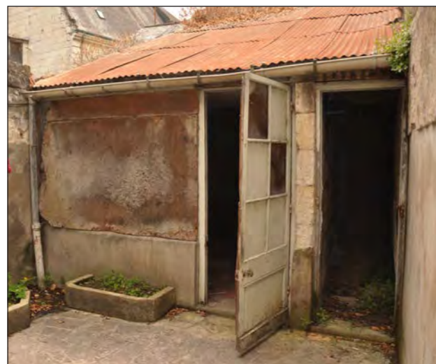
Fig.89 : Bâtiment aux modes constructifs incohérents et portant atteinte à la sécurité des personnes.
