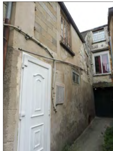
Fig.58 : Bâtiment aux modes constructifs incohérents et qui dégradent l'état sanitaire de l'ensemble.
