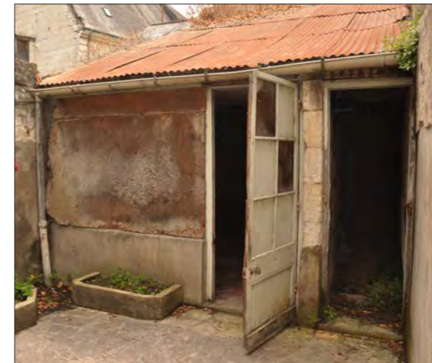
Fig.59 : Bâtiment aux modes constructifs incohérents et portent atteintes à la sécurité des personnes.
