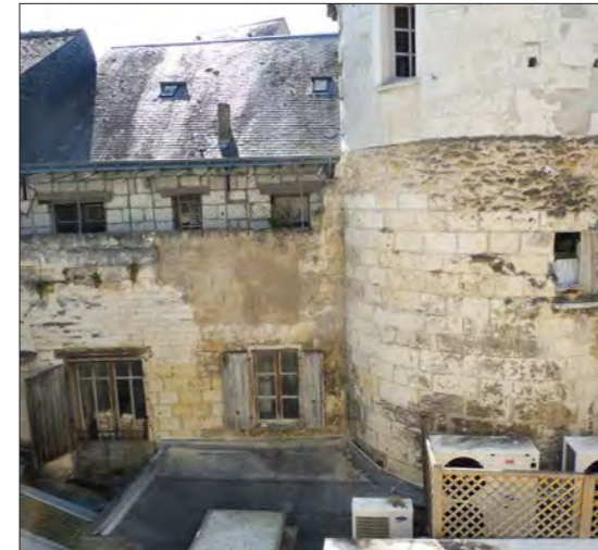
Fig.55 : Bâtiment construit sur l'emprise d'une ancienne cour. Empêche l'entretien du rempart et ne permet pas une démarche de développement durable.
