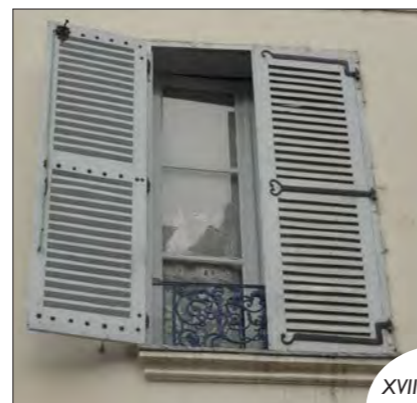
Fig.534 : Rue du Château (6)
