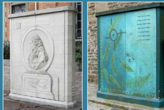
Exemples d'armoires électriques
